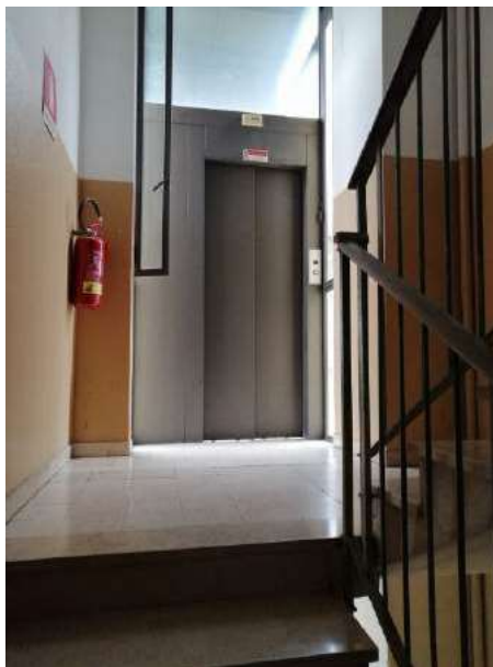
Foto 7 – Sbarco ascensore al piano 3°
